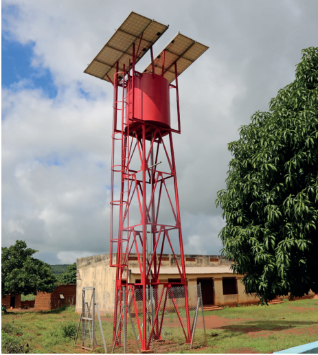
새로 지어진 태양열 급수탑(Solar water tower)
